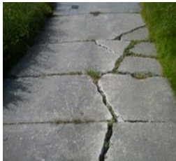
Vorher: maroder Betonplattenweg
